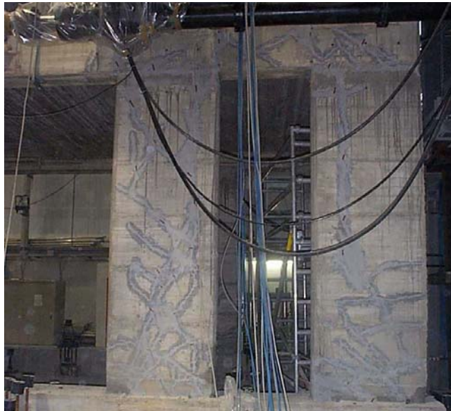
Figura 15. Fessure iniettate con resina epossidica
