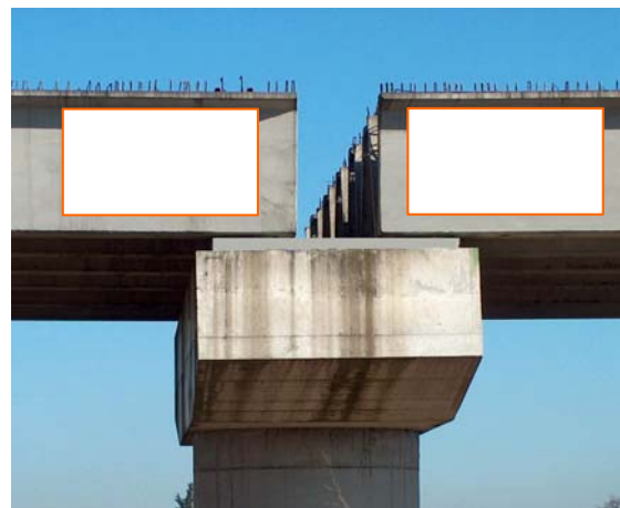
Fase 2: Getto baggiolo con appoggi inglobati e zona infissione connettori cls-cls evidenziata
