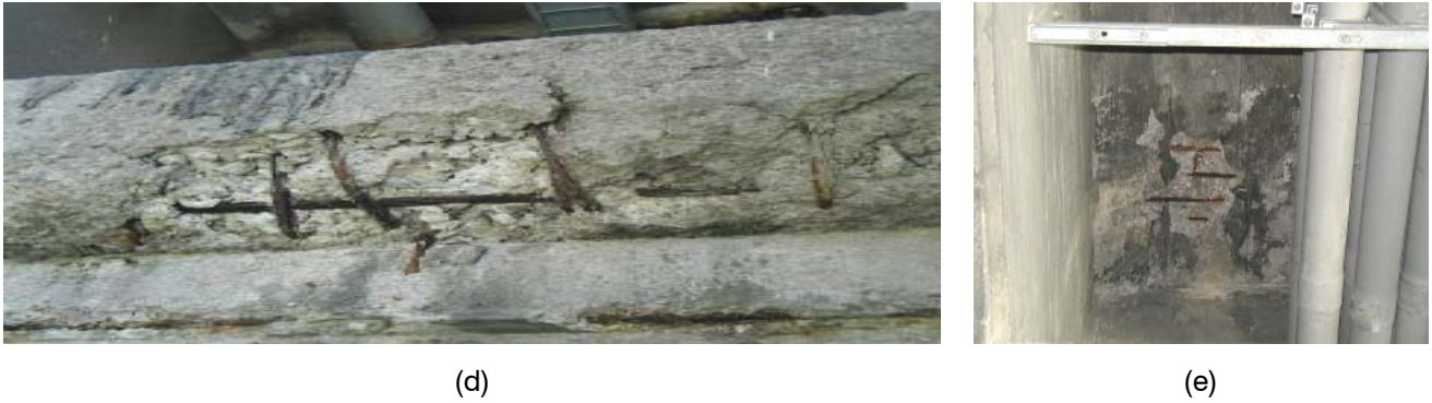
Fig.6: Alcune patologie presenti sulla struttura in esame
