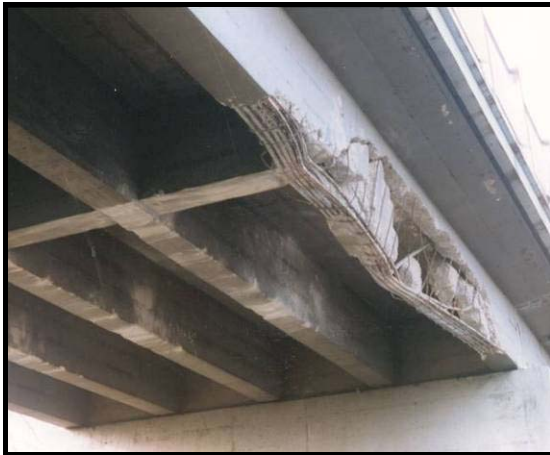
Fig. 8: mancato rispetto del limite di altezza
