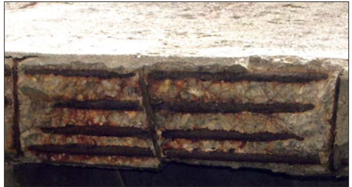
Fig. 2: Vista della corrosione delle armature principali delle travi esterne
