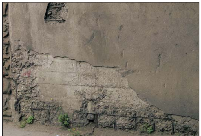
Fig. 5: Vista del degrado al piede della parete in calcestruzzo che funge da pila
