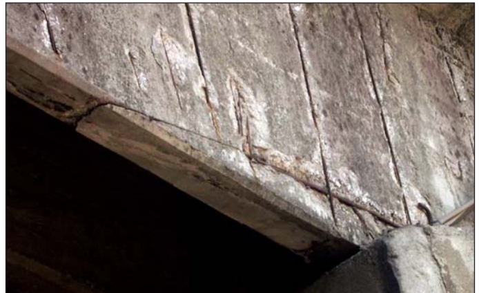
Fig. 4: Vista del distacco del copriferro causato dalla spinta delle barre
