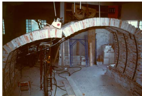
Figura 8. Ponte in muratura rinforzato in composito caricato sino al collasso. Prova condotta dalla 4Emme di Padova (ing. Lionello).
