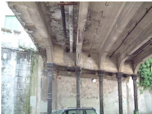
Figura 9. Ponte in C.A. carente di sicurezza, oltre che degradato.
