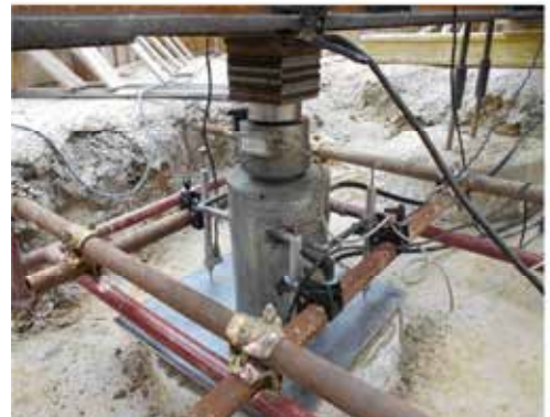
Cella di carico e martinetto idraulico
